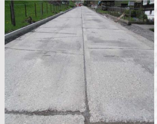
Поперечные трещины. Слишком длинные плиты
