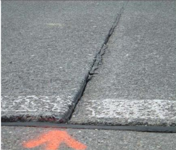
Нарушение ровности дорожного покрытия
